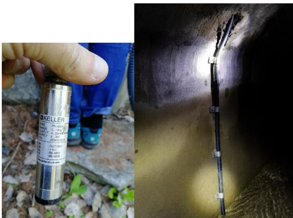
Sensore idrometrico installato all'interno del canale
