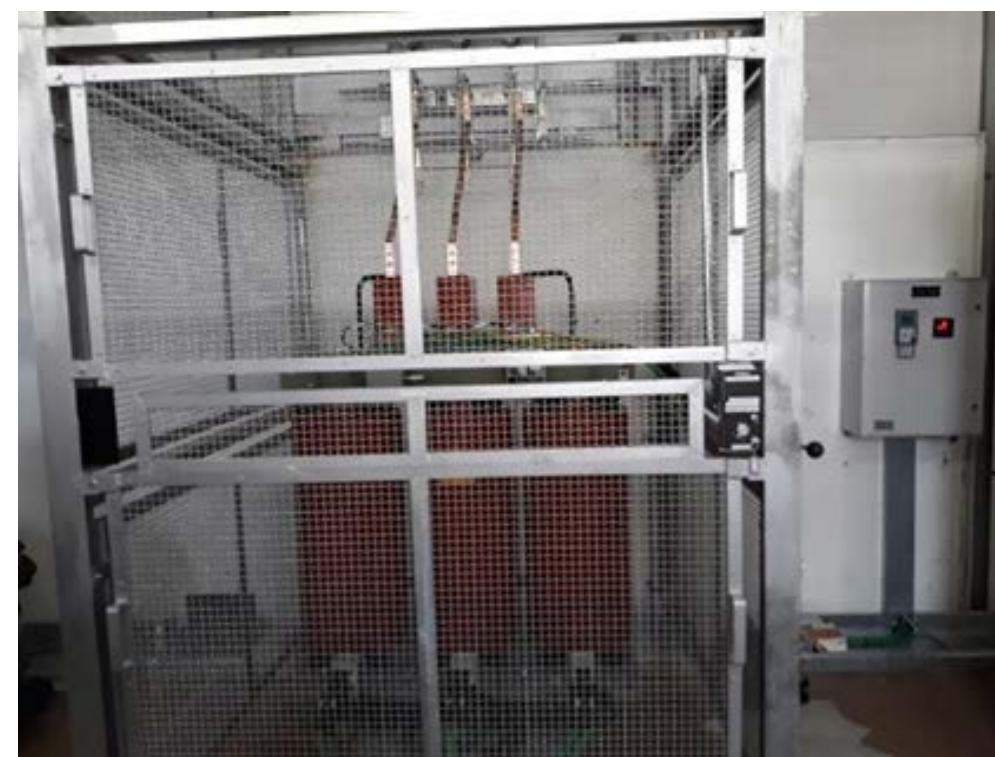
Trasformatore di eccitazione (TE)
