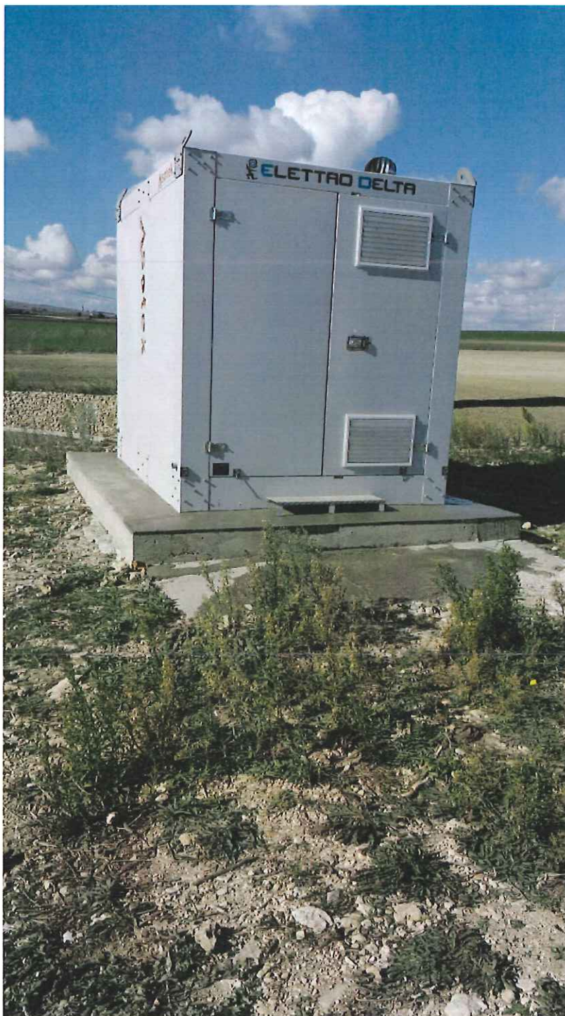
Foto 4 : Cabina di smistamento impianto Lamacarvotta
