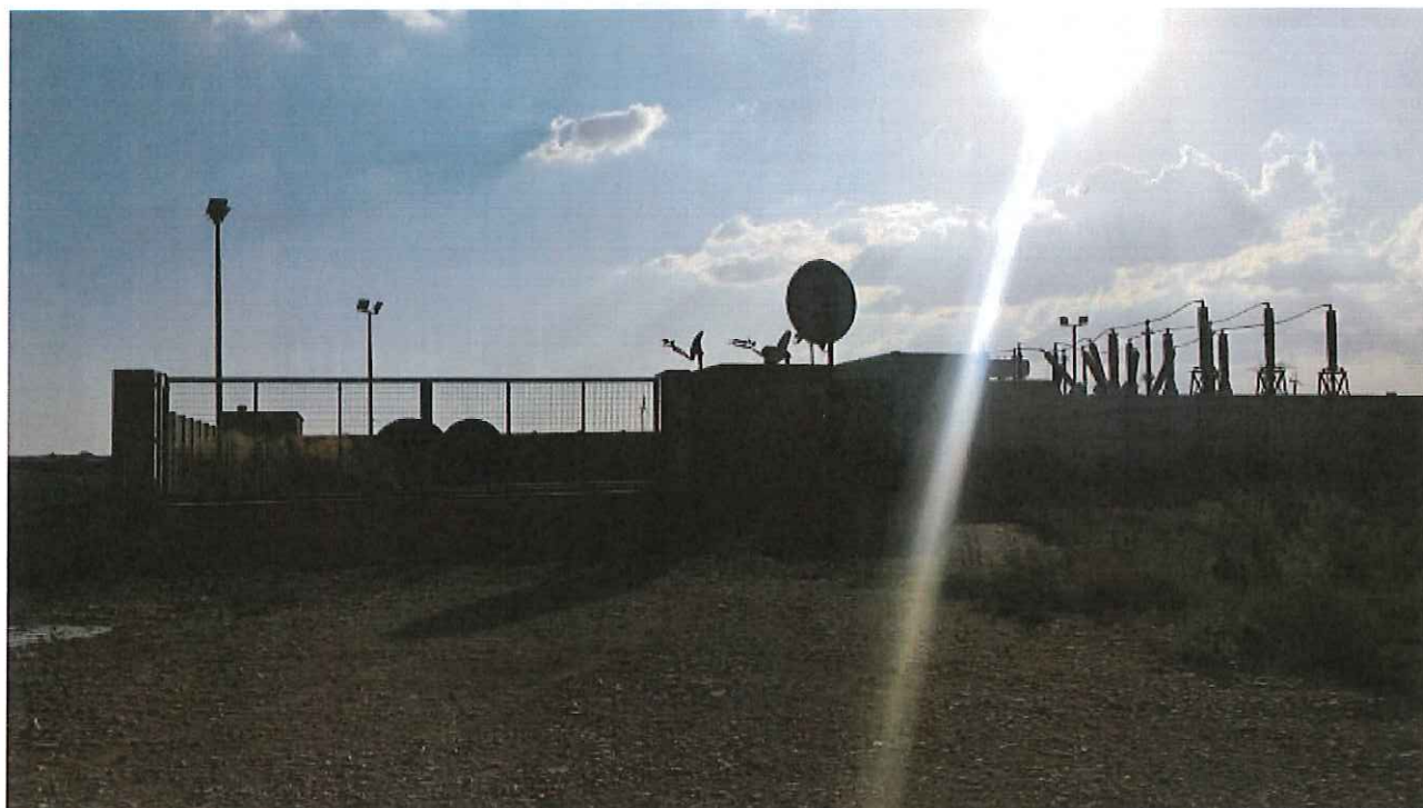
Foto 4 : Sottostazione elettrica di trasformazione
