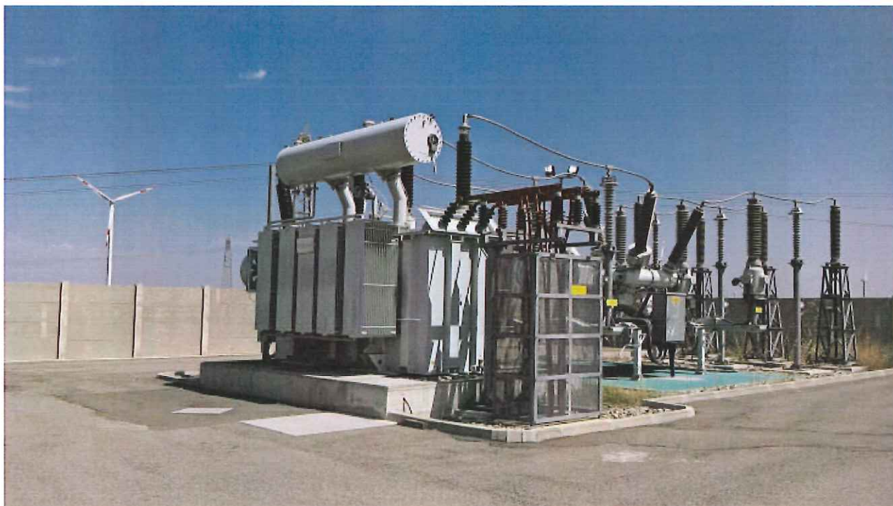
Foto 3 : Trafo MT/AT PASS M0
